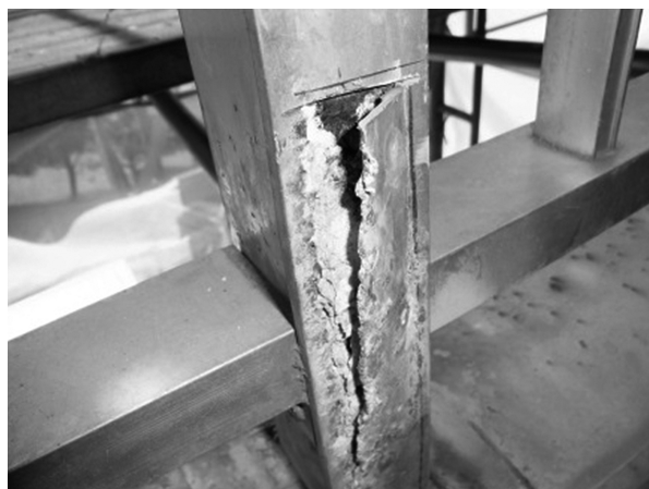
写真1 不具合事例(支柱の腐食)
