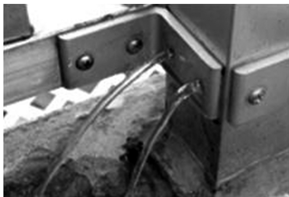
写真2 不具合事例(支柱内の雨水の耐水)
