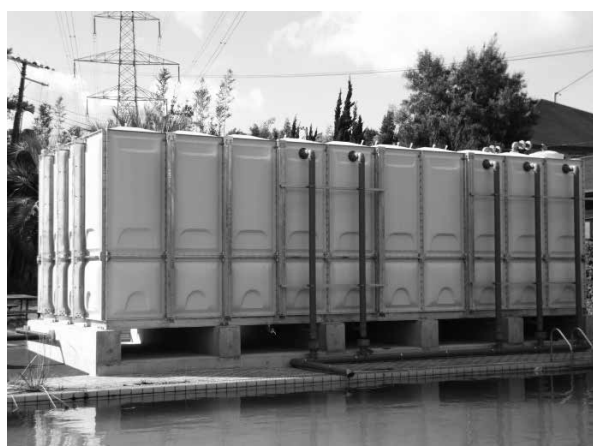
写真1 FRP製パネルタンクの設置例
