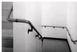
階段に設置された補助手すり
